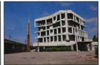
地震により被災した庁舎
