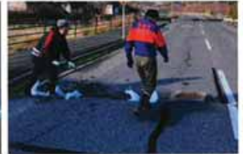
1月2日、輪島市門前町において、輪島市消防団が、道路の亀裂部分に土嚢を埋め、通行を可能とする応急対策を実施
